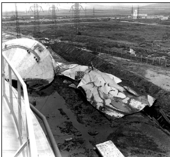
Рис. 1.12. Общий вид аварийного РВС № 2 после разрушения
