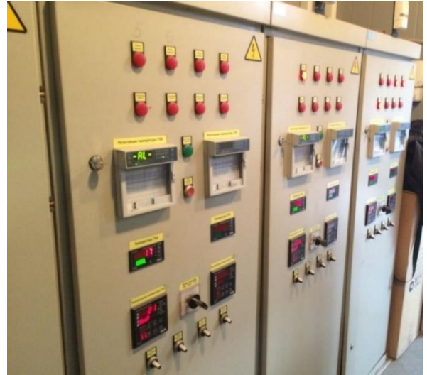
Рисунок 4.15 – Шкафы контроля температурного режима в печи для каждой форсунки, участвующей в испытании
