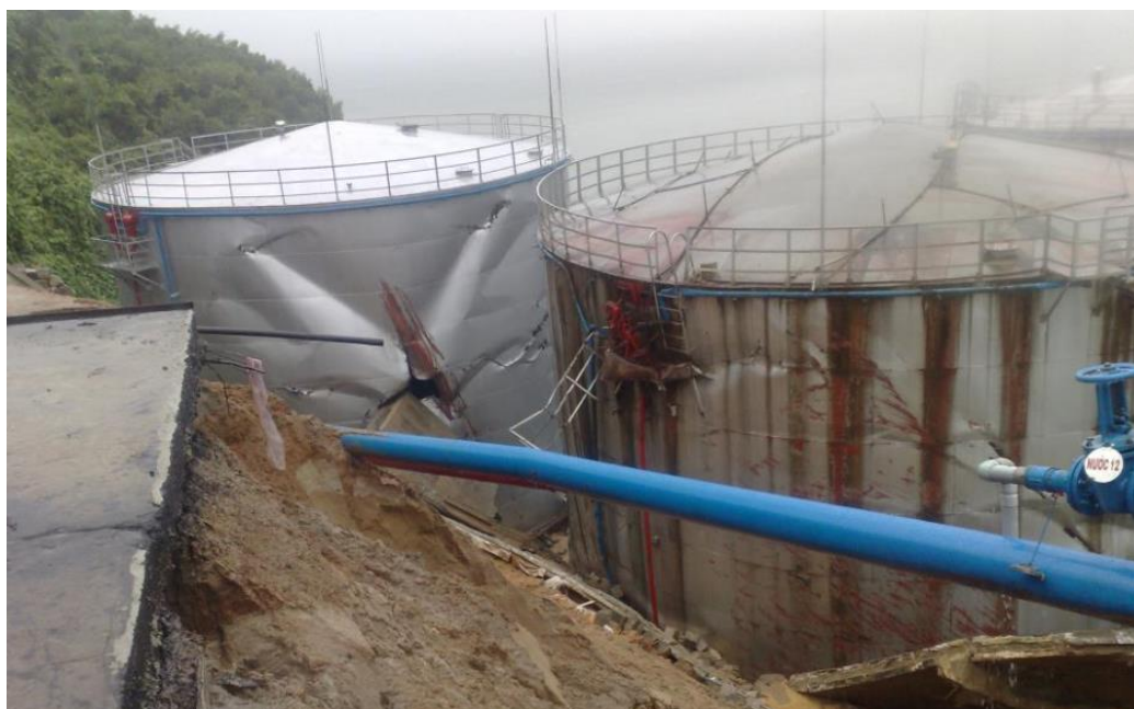
Рис. 2. Общий вид резервуаров на нефтебазе Льен Чиену после ликвидации аварии
