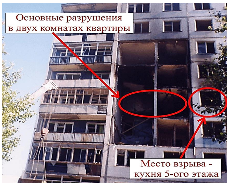
Рис. 2. Последствия аварийного взрыва пропано-воздушной смеси в двухкомнатной квартире
