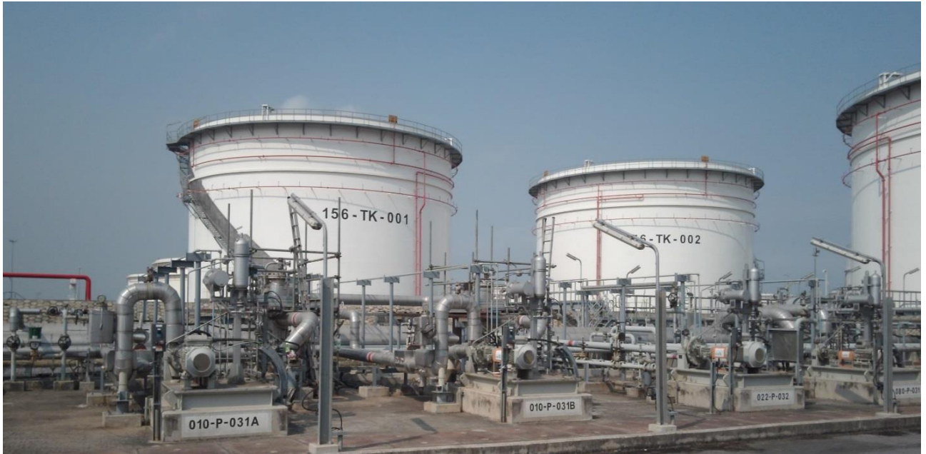
Рисунок 2.3 – Резервуары типа РВСПК-14000 м 3 и перекачивающие насосы на нефтебазе НПЗ «Нги Сон»
