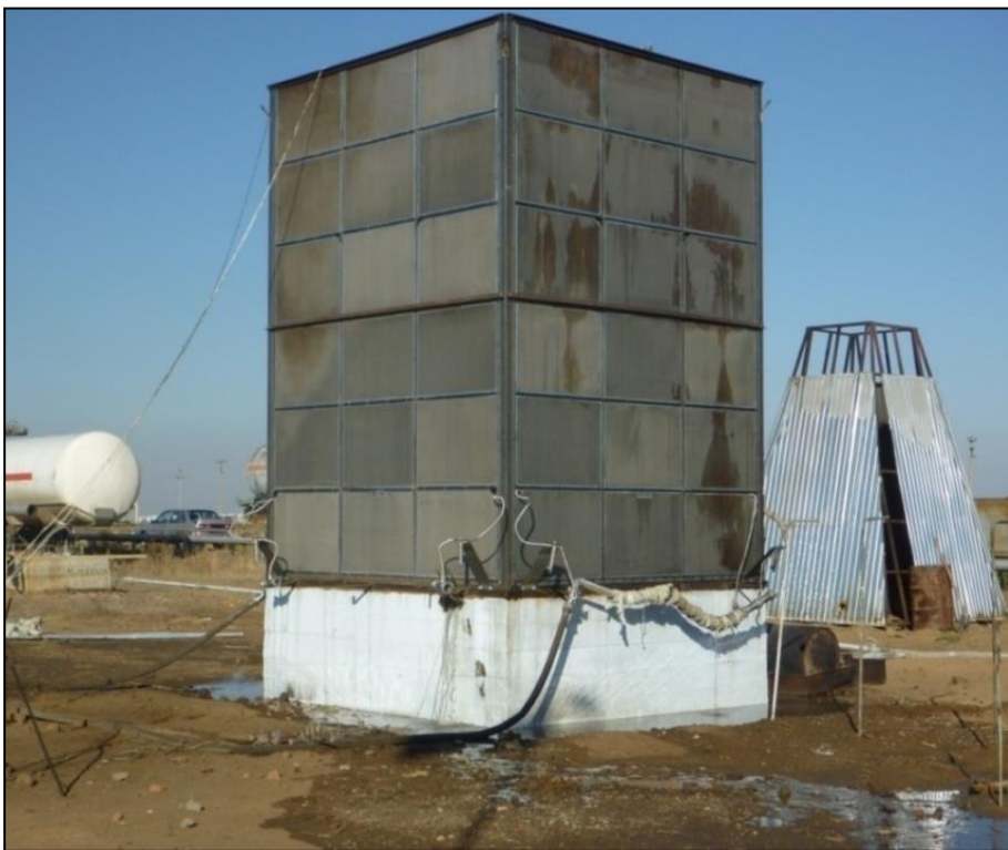
Рисунок 4.16 – Общий вид смонтированного противопожарного устройства
