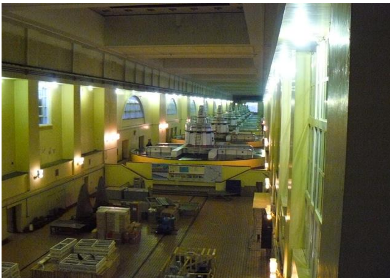
Рисунок 8 - Общий вид машинного зала Нижегородской ГЭС
