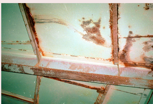
Внутренняя поверхность кровли резервуара защищаемой покрытием «Танкгард ХБ» после одного года эксплуатации
