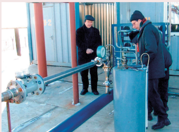
На установке получения азота для подачи его в резервуары. Бегишев И. Р. и главный инженер НПП «Криосервис» Крикунов А. А. в резервуарном парке «Самаранефтегаз»
