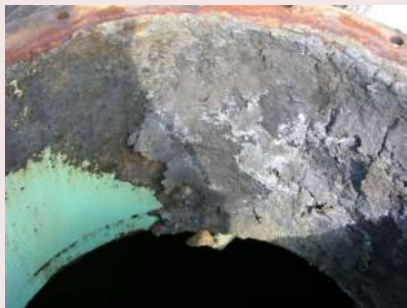
Коррозионные пирофорные отложения на горловине люка товарного резервуара
