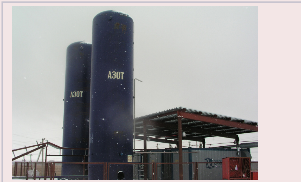
Азотодобывающая станция и ресиверы для накопления и подачи азота в резервуары
